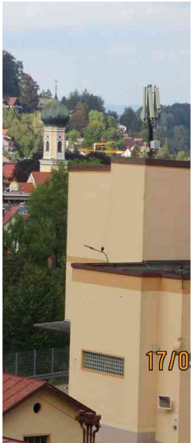
Teil der zwei Mobilfunksendeanlagen auf Firma Gottesackerstr. 2 mit insgesamt 33 Antennen
