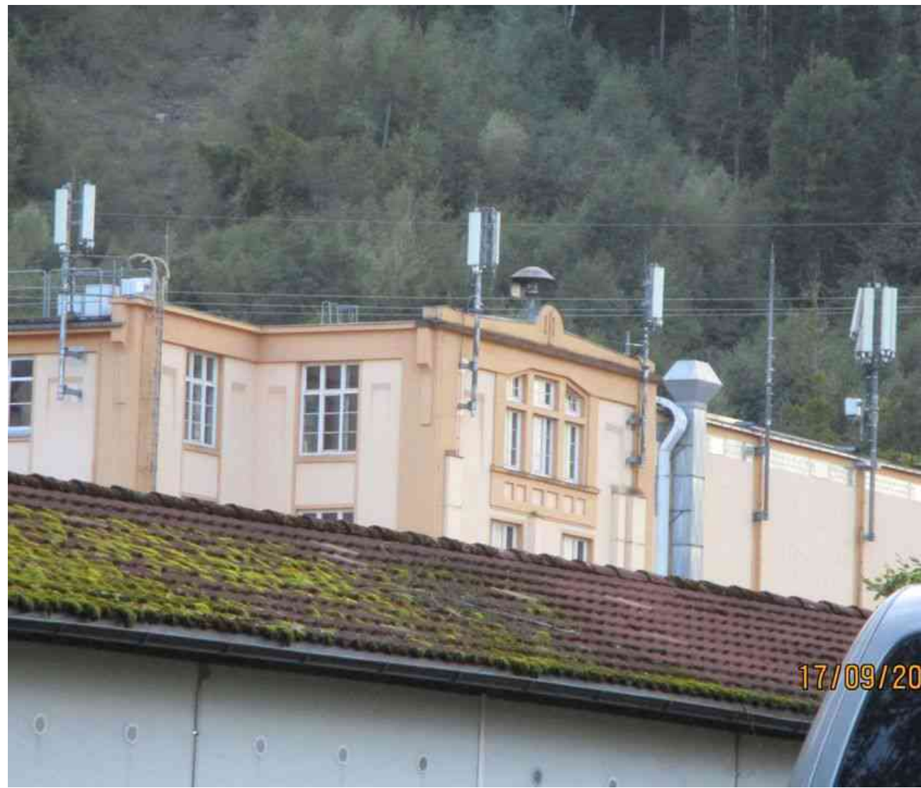
Auf der Firma Gottesackerstraße 2 (746 m ü. NN) sind 33 Sektorantennen von zwei Mobilfunk-Sendeanlagen mit Standortbescheinigungs-Nr.: 540274 und Nr.: 541064 verteilt.
