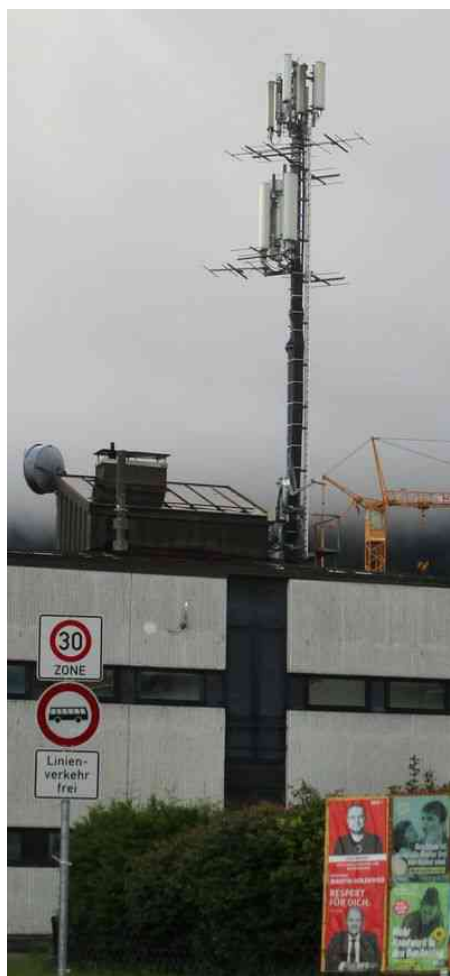
Mobilfunksendeanlage Im Steinach 2 H: 18- 21m, 6x 80°, 6x 200°, 6x 320°
